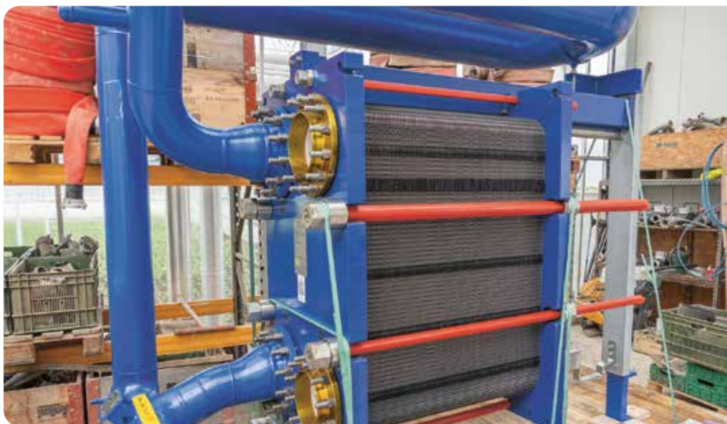
Einige Gewächshaus-Betriebe installierten eine Wärmepumpe.
