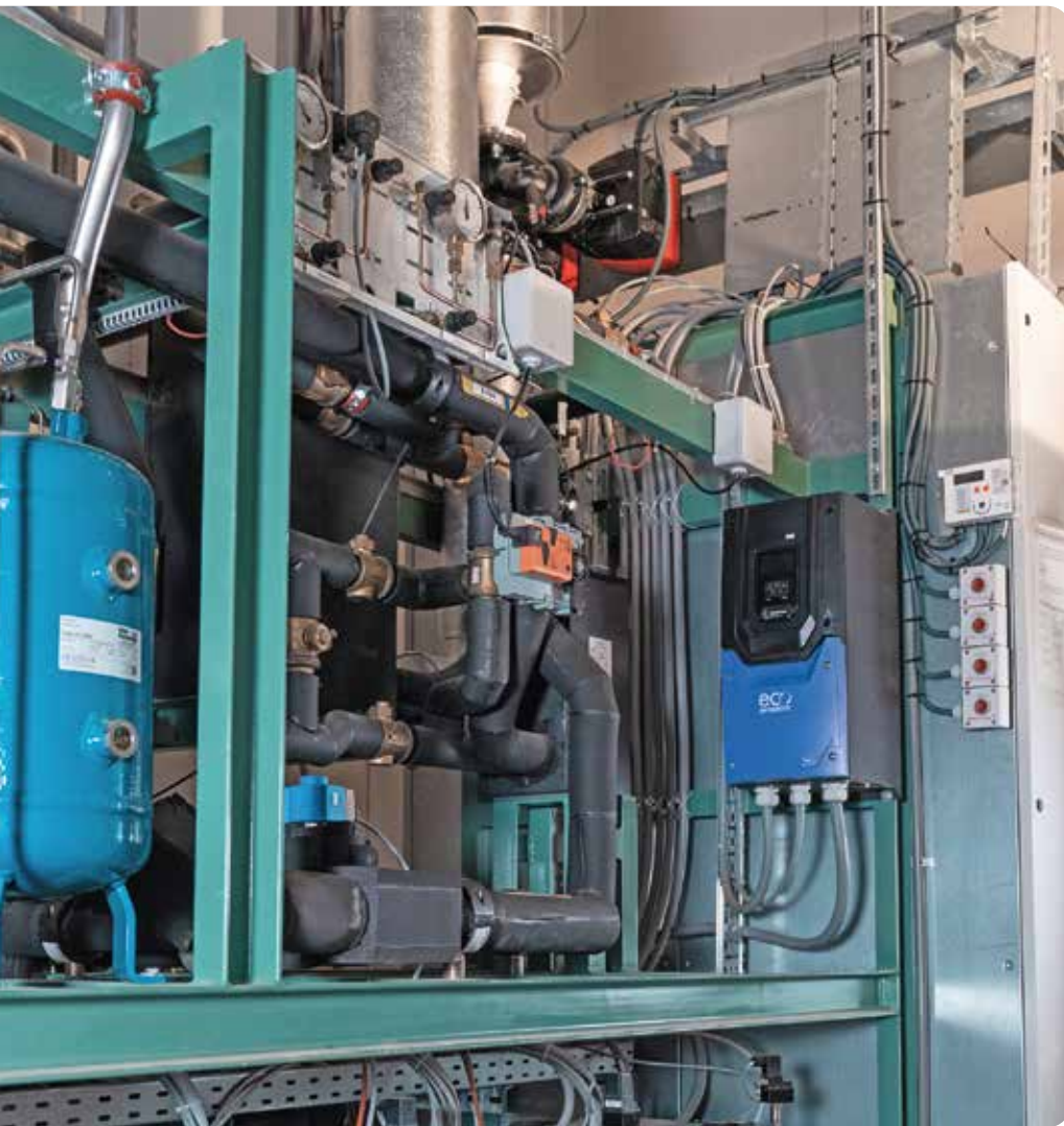
Die Kälteanlage wird mit dem natürlichen Kältemittel CO 2 (R-744) betrieben.
