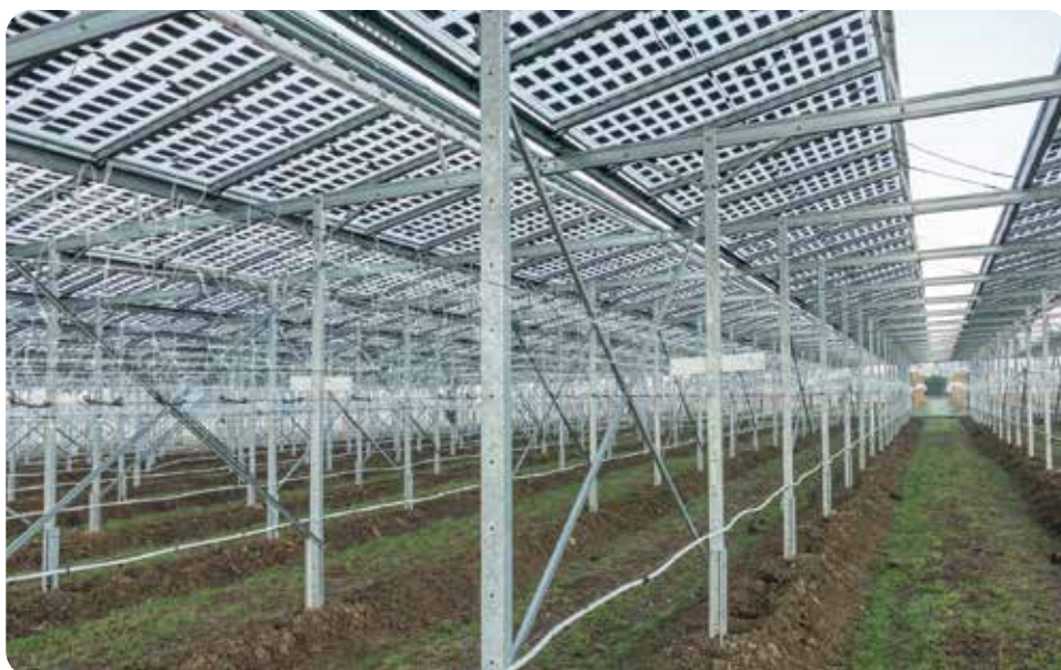
Das letzte InnoBoard widmete sich dem Thema Agri-Photovoltaik, hier die Lösung von Insolight.
